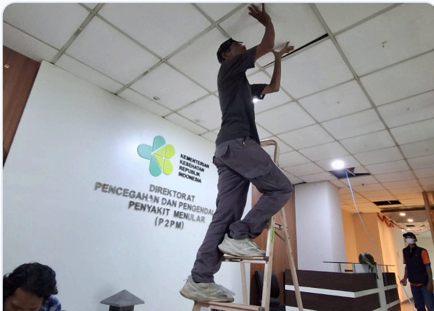
Instalasi CCTV KEMENKES RI
